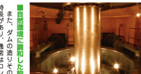
▲発電電動機の一つ下に位置するポンプ水車部分。右に回ると発電、左に回ると揚水を行います。通常、大平発電所は無人のため、これらの操作を八代電力所から遠方制御しています。
