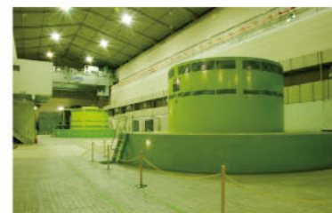
▲地下発電所は熊本城がすっぽり収まってしまうくらい大きさ。この中に2つの巨大な発電電動機が据え付けられています。
